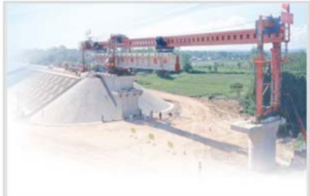
2018年12月2日,中老铁路首片简支T梁在老挝首都万象市成功架设,标志着中老铁路建设工作由线下施工转为线上施工。本报记者 赵益普摄
